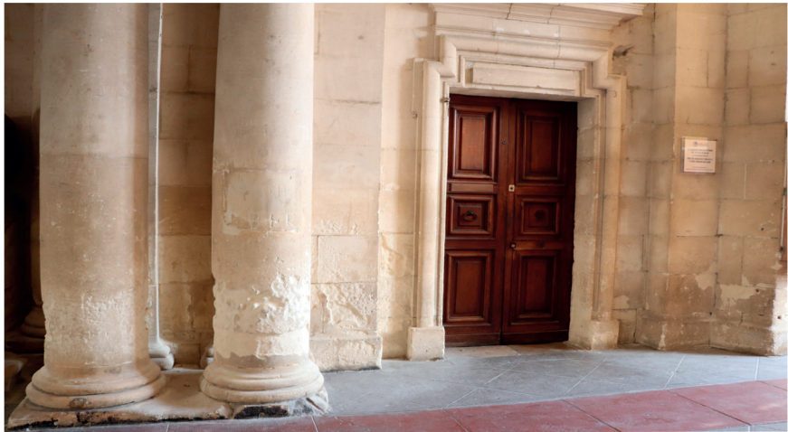
Vestibule de l'Hôtel de Ville, où apparaît l'altération des colonnes en calcaire. ©La Fabrique de la Cité
